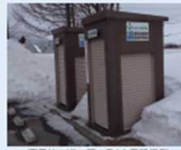
寒冷地の道の駅のEV充電設備例
